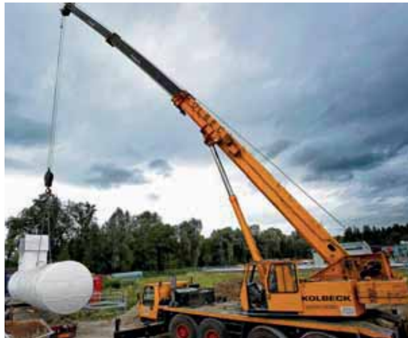
Ins Gruppenklärwerk in Lauben wird stetig investiert. Das Foto zeigt die Anlieferung eines neuen Methanoltanks. Weil die Investitionskosten über einen langen Zeitraum auf die Gemeinden umgelegt werden, bleibt die Umlage stabil.
